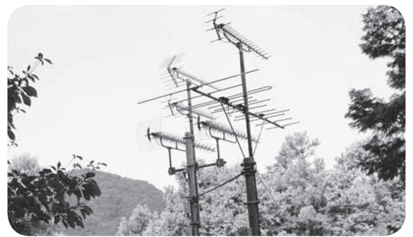
兎之山地区の地上デジタル放送共聴施設
