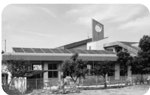
ひまわり幼稚園に設置されている太陽光発電パネル
