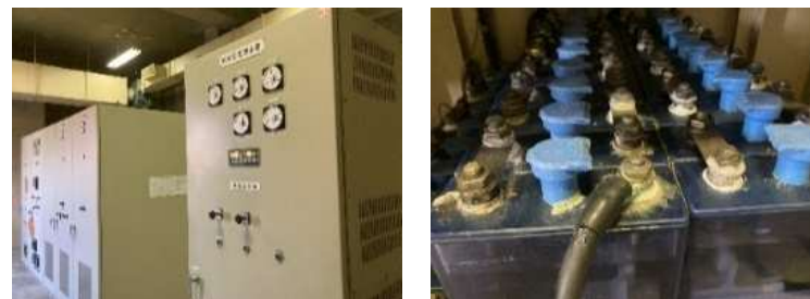
老朽化した電気設備(唐樋ポンプ場)
