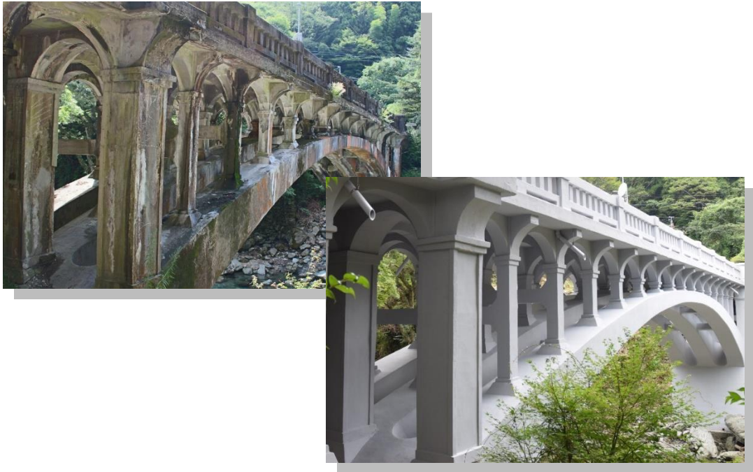
大宮橋 (社)土木学会 選奨土木遺産 西条市西之川、昭和2年完成、令和2年度修繕完了〔全建賞受賞〕
