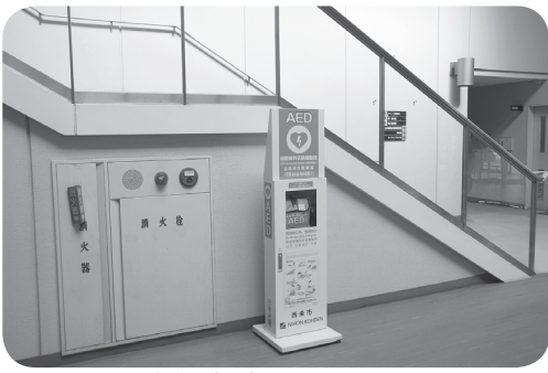
西条市総合体育館に設置されているAED
