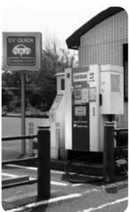
石鎚山ハイウェイオアシスに設置されている充電設備
