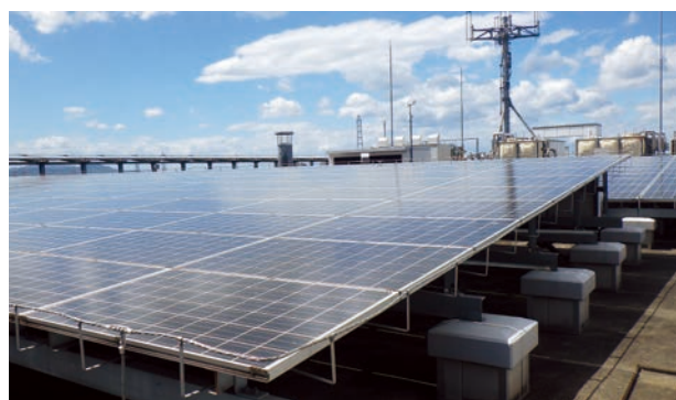
市役所屋上の太陽光発電設備
