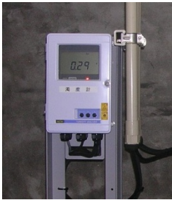
水源のにごり(濁度)監視設備
