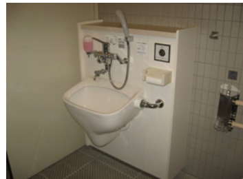
公共施設に設置したオストメイト対応トイレ
