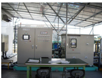
MH冷水製造システム
