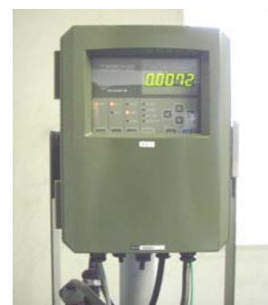
(濁度計 玉津東部水源地)
