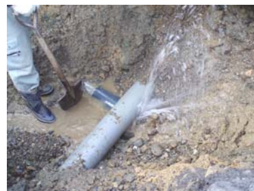
(配水管の破損による漏水)
