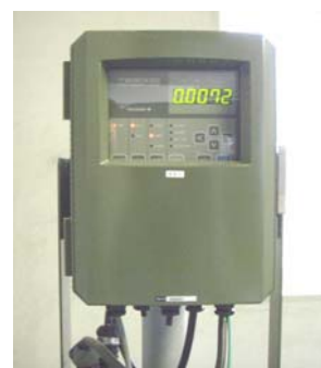
(濁度計 玉津東部水源地)
