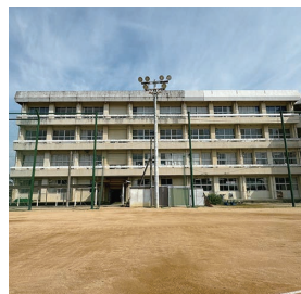
▲老朽化が進む学校施設の躯体健全化を図ります
