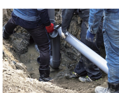
未接続の方は必ず工事を
