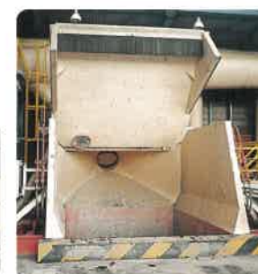
展開検査設備
