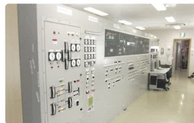
排水処理施設 中央監視操作室
