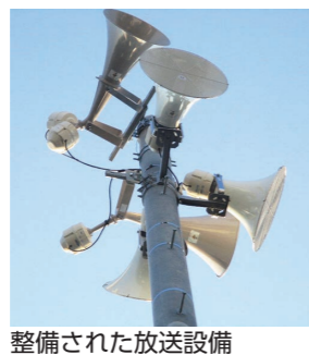
整備された放送設備
