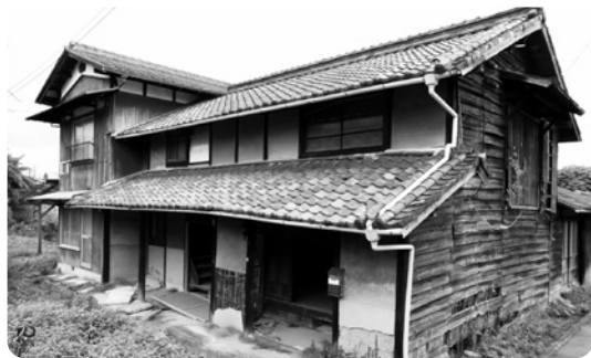
老朽化で活用できない空き家
