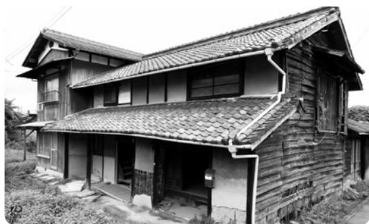
老朽化で活用できない空き家
