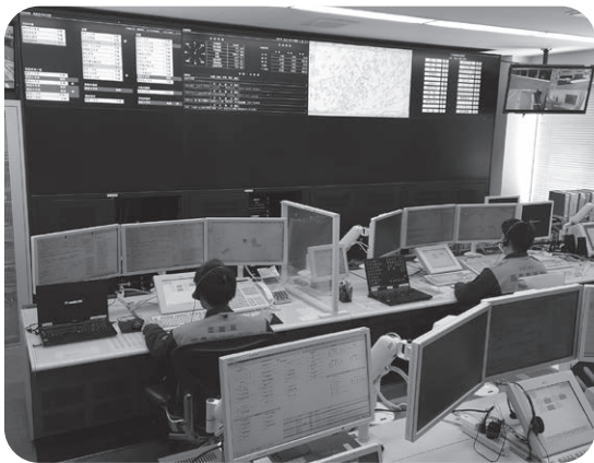
部分更新される消防緊急通信指令システム
