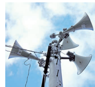
整備された放送設備
