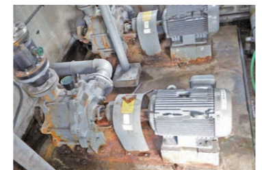
▲老朽化したポンプ
