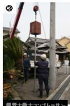
④ 鋼管+ポンプ+コンプレッサー
