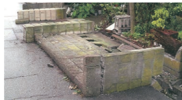
地震により倒壊したブロック塀
