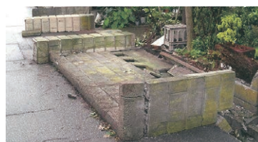
地震により倒壊したブロック塀
