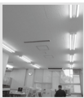
サイクスに設置されたLED蛍光灯
