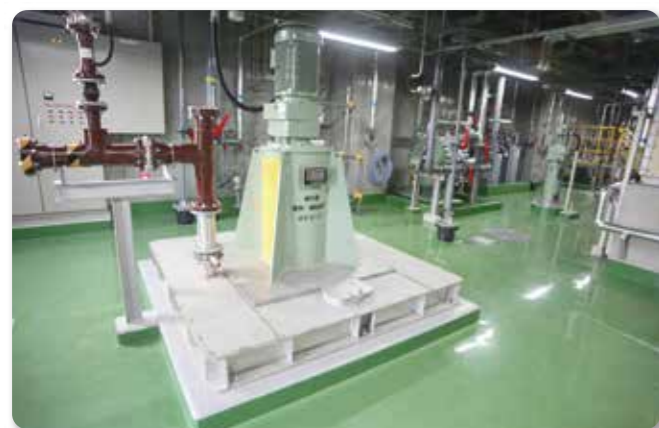
硝化槽攪拌・曝気装置
