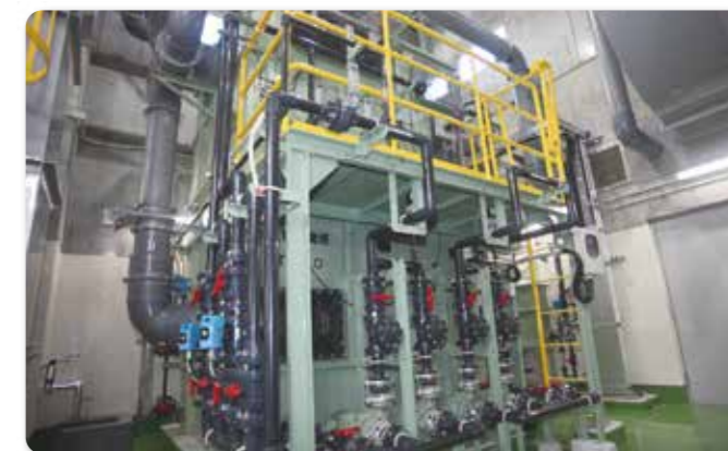
生物脱臭塔・薬液洗浄塔
