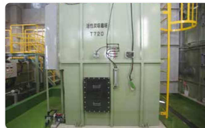
活性炭吸着塔
