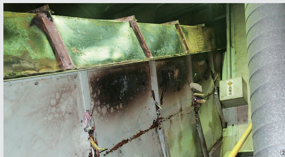
①7月13日に発生した火災。約2時間30分後に消し止められた ②火災により焦げたコンベヤ ③指定日以外に出され、カラス被害にあっているごみ ④粗大ごみステーションで出た、粗大ごみシールを貼っていない違反ごみ
