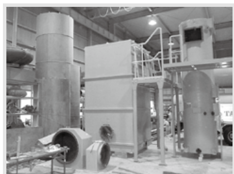
脱臭装置プラント （中央が生物脱臭装置）
