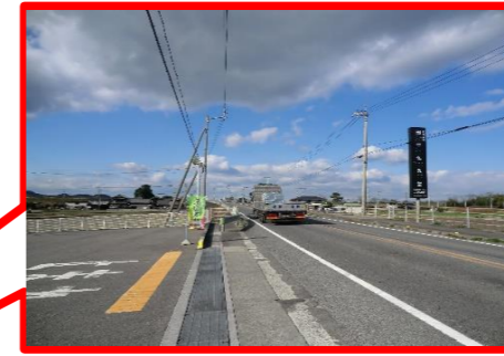
高田633-3先路上(国道196号) 2件発生(うち重傷1件)
