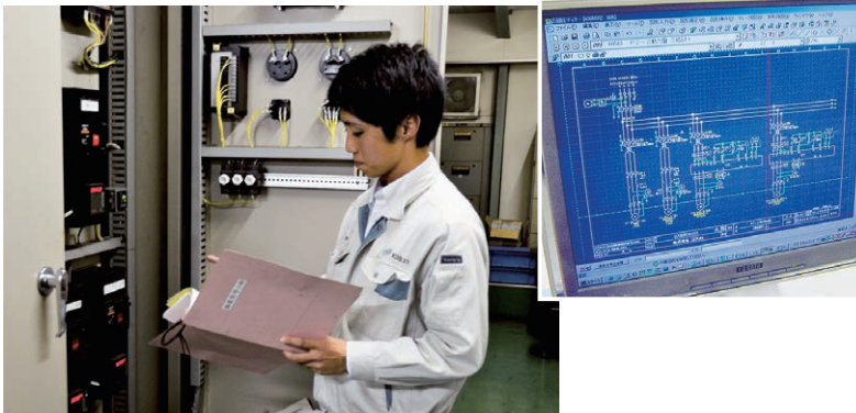
▲制御盤の動作をチェック
