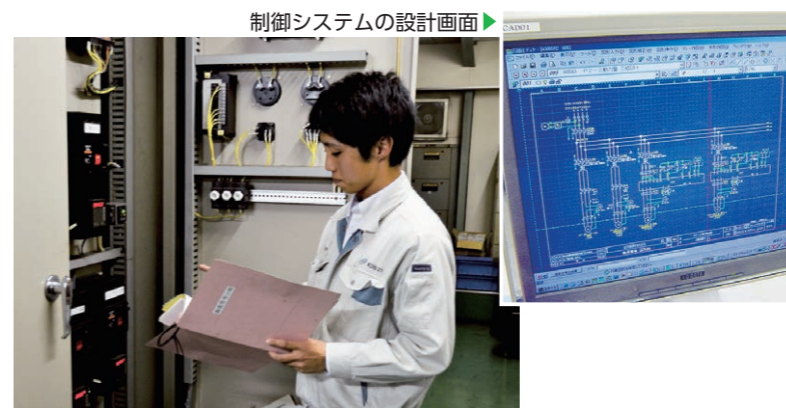
▲制御盤の動作をチェック
