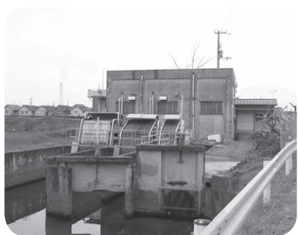
重点的に整備している三津屋雨水ポンプ場
