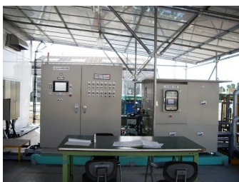
MH冷水製造システム
