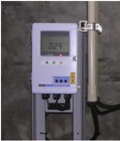
水源のにごり(濁度)監視設備
