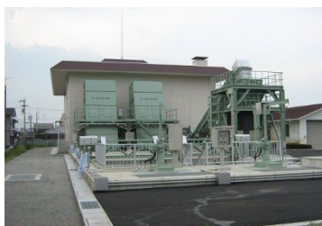
供用を開始した本河原雨水ポンプ場
