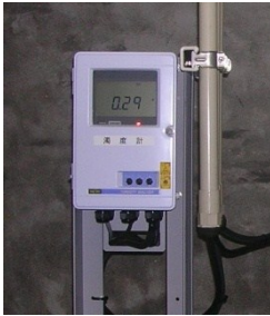
水源のにごり(濁度)監視設備
