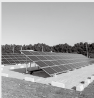
▲場内電力を賄う太陽光発電パネル
