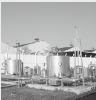
▲工場排熱で温水を作る熱交換器
