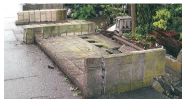
地震により倒壊したブロック塀
