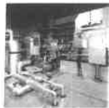
5 蒸気タービン発電機
