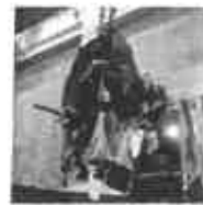
不燃・粗大ごみピット
