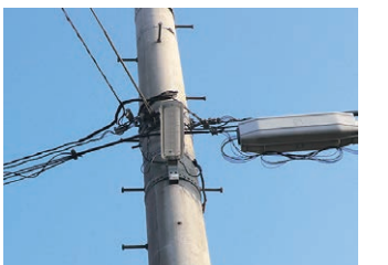
LED器具を使用した防犯灯
