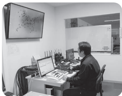
市庁舎災害対策本部室内の防災行政無線
