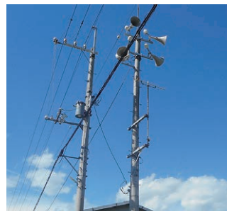
整備された放送施設
