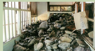
▲土石流で埋まる大保木公民館
