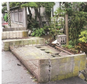
倒壊したブロック塀
