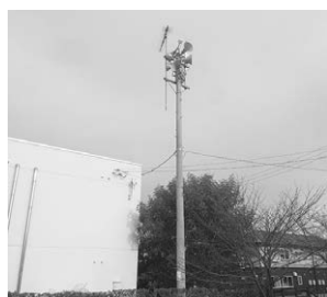
▲整備された三津屋集会所運営委員会の放送施設
