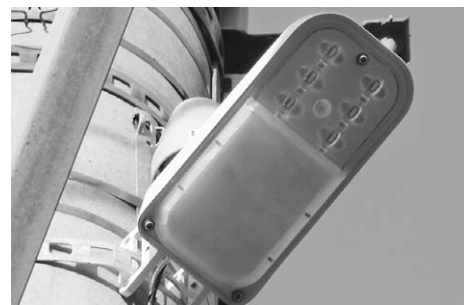
▲今年度設置された街路灯
