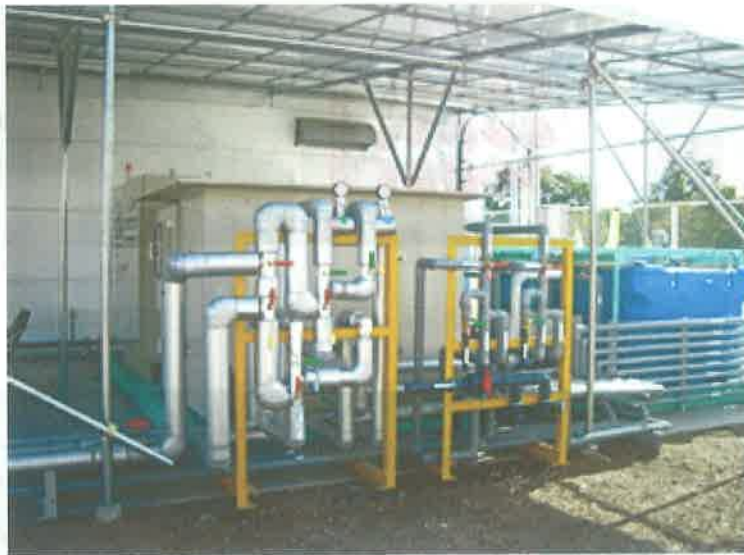
水素冷凍・冷水製造システム(愛媛県西条市)
