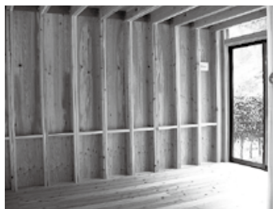
▲石鎚ふれあいの里に設置してある耐震木製構造物の内部
