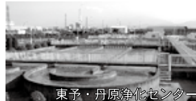
▲各汚水処理施設の反応タンク ※東予・丹原浄化センターでは汚水攪拌(かくはん)型の処理方法を採用し、最初沈殿池は省略して処理しています。
