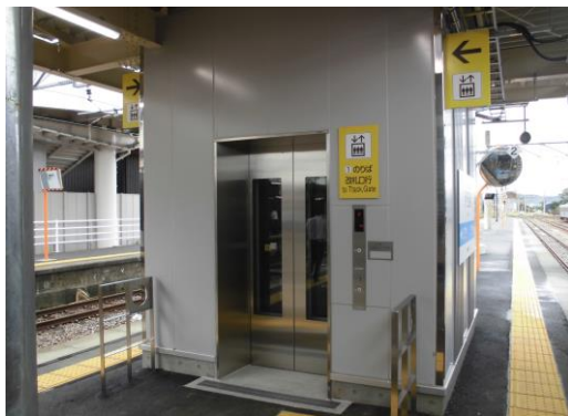
エレベーター（2・3番ホーム）
